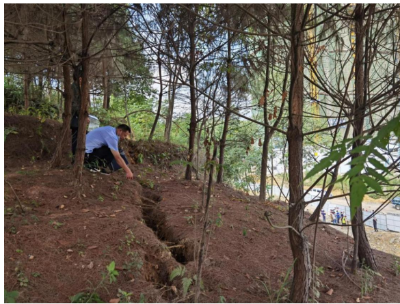
照片2 第2段边坡后缘拉张裂缝
