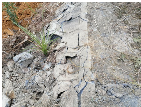
照片4 第6段边坡前缘护坡挡墙鼓胀变形
