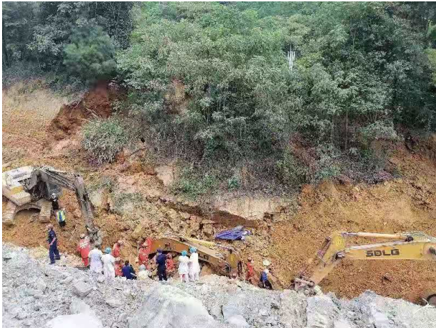
照片1 边坡坍塌救援现场
